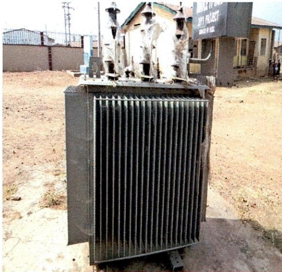
Ileje-Meje LG-300KVA 33/0.415KV Else Wedy Transformer, S.N.1003000437 Inside the Palace, Iye-Ekiti.
