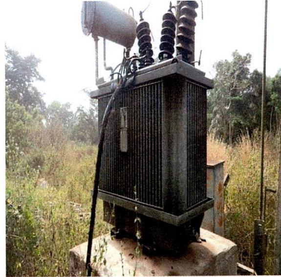
Ileje-Meje LG-200KVA 33/0.415KV Minel Transformer, S.N.107173, Opposite Unity Guest House, Ileje-Meje.
